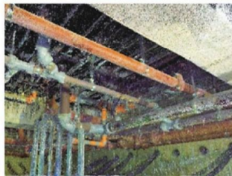
3Dスキャナで撮影した職業大の地下ビルの配管
